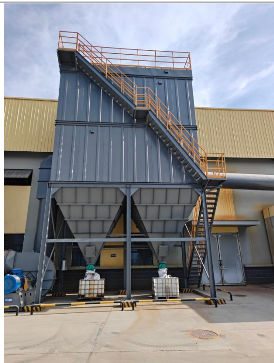
电解炉布袋除尘器（新建）
