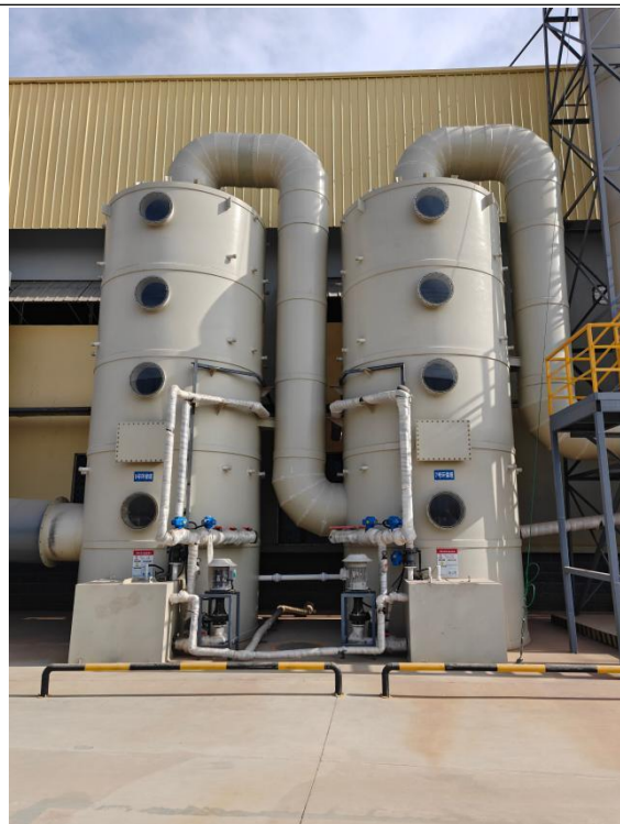
两级碱喷淋塔（新建）
