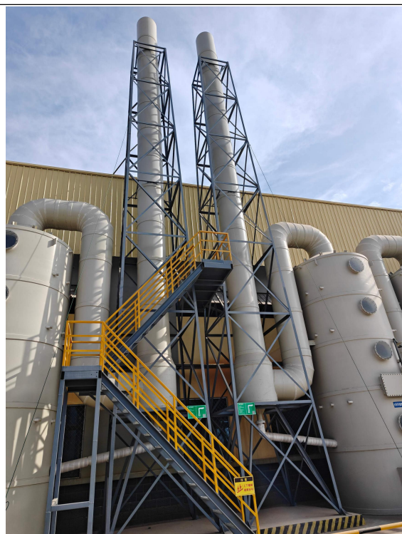
电解废气排气筒（新建）
