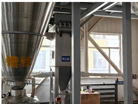
混料机及共用脉冲除尘器（依托）
