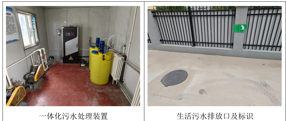
图 4-4 一体化污水处理装置照片
